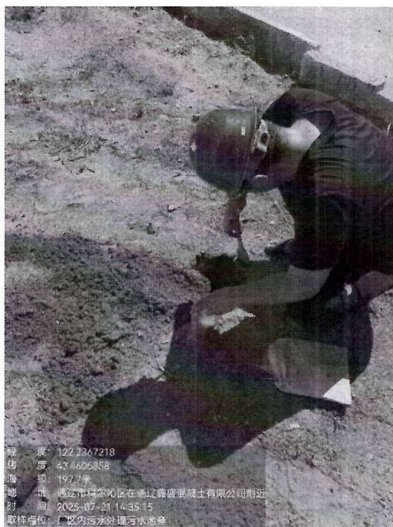
厂区内污水处理污水池旁
